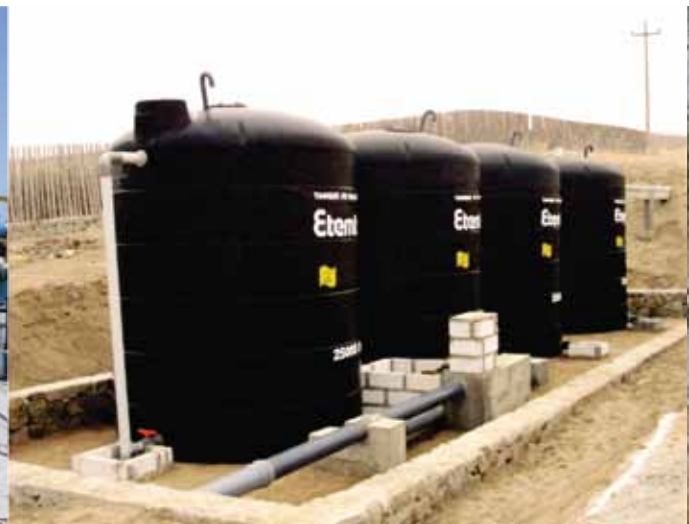
TRATAMIENTO DE AGUA
